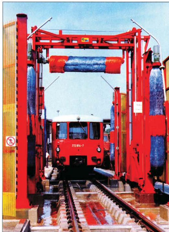
Triebfahrzeugwaschanlage im Bw Eisenach – ein Neubau, der in Blankenburg (Harz) hergestellt wurde.
